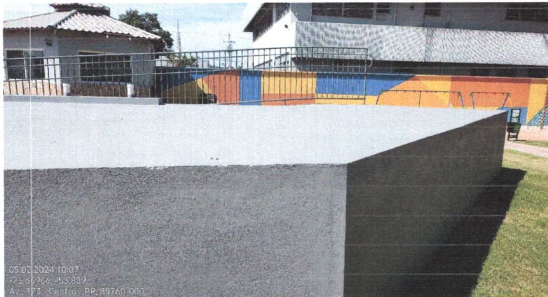
Foto 02 – Falta o granito no bordo do palco
