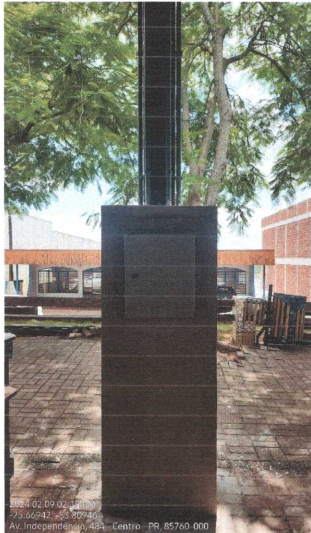
Foto 31 – Quadro de energia da rua coberta
