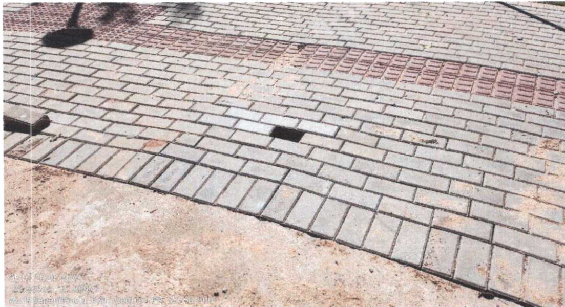
Foto 01 – Paver danificado com passagem de veículos pesados
