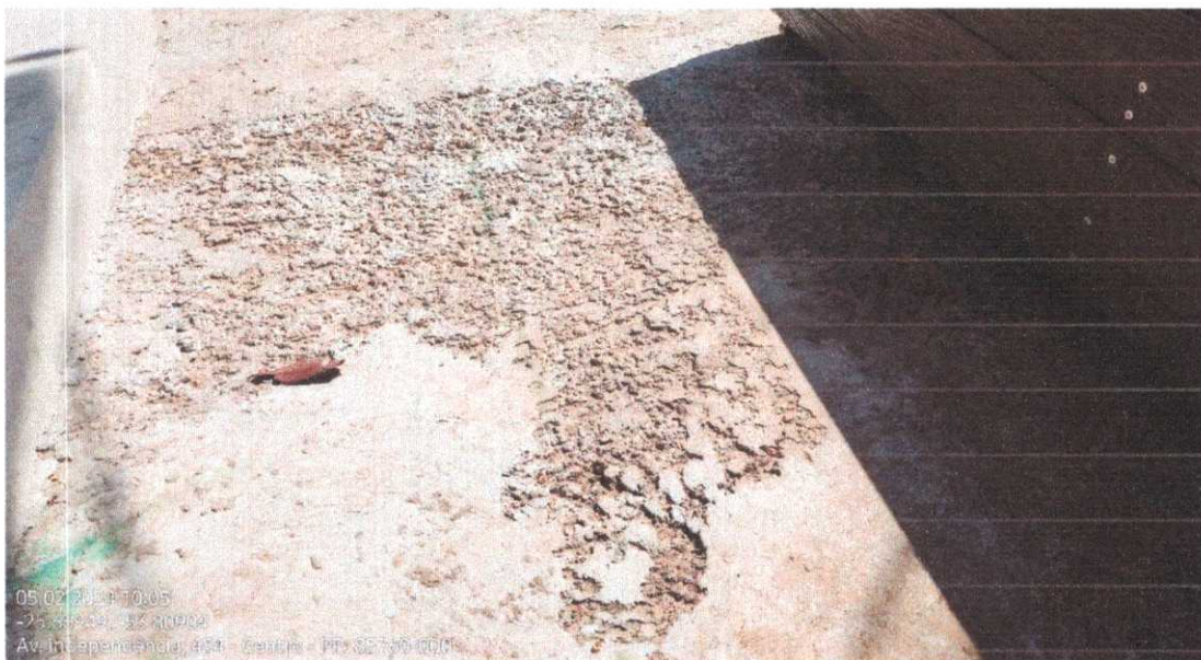
Foto 09 – Piso de concreto irregular
