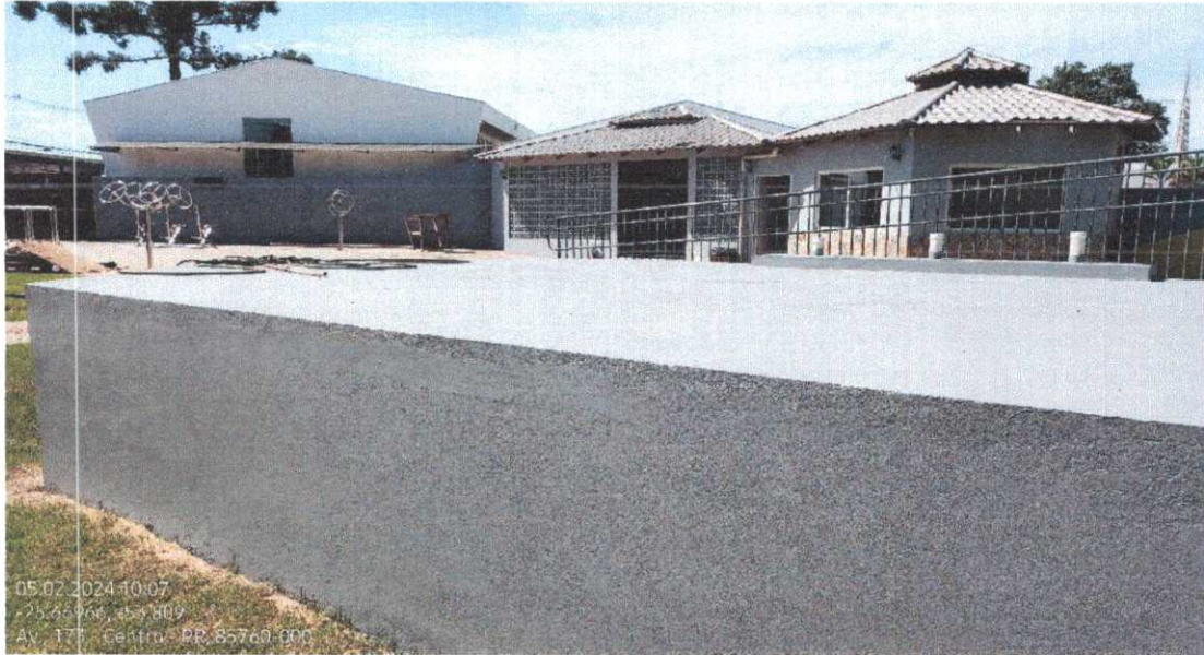
Foto 03 – Falta o granito no bordo do palco
